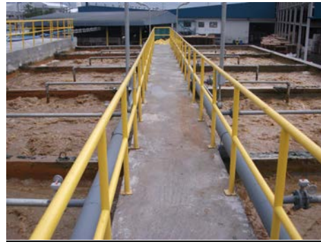
บ่อ Aeration tank
