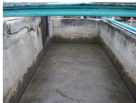
บ่อ Sludge tank
