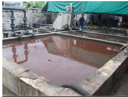
บ่อ Wastewater sump
