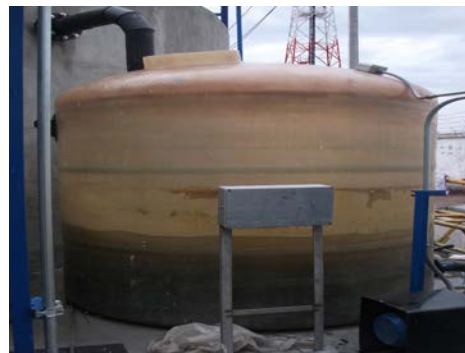
บ่อ Effluent tank
