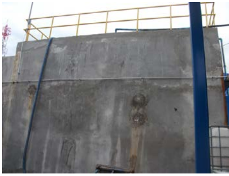
บ่อ Anaerobic media tank
